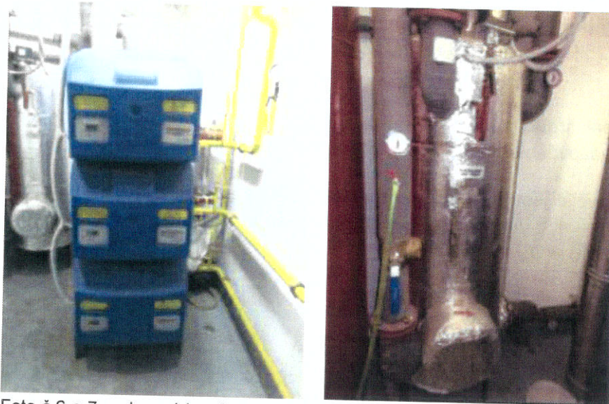
Foto č.6 a 7 – plynový kondenzační kotel a anuloid (oddělovač kotlového-primárního okruhu topné vody a sekundárního okruhu topné vody pro objekt).
