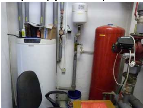
Zásobníky v kotelně 3.NP
