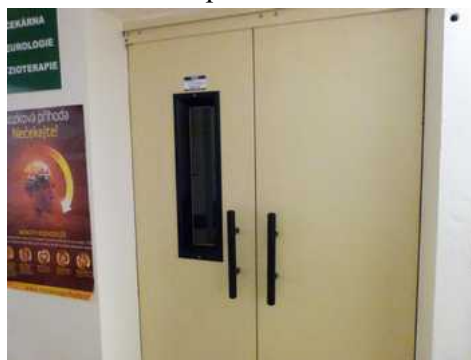
Stanice výtahu na chodbě 1.NP
