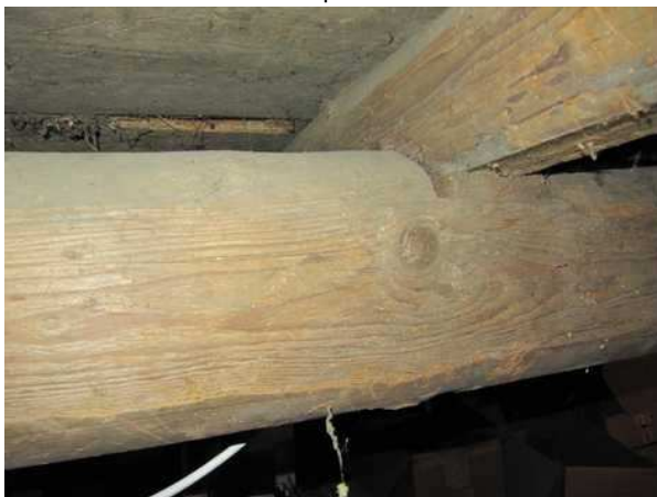
krov - detail (stopy po dřevokazných škůdcích)
