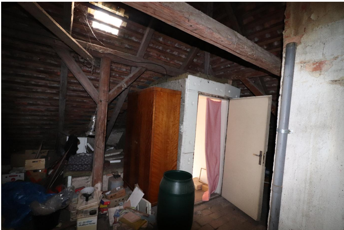
Odvětrání kanalizace do půdního prostoru- nevhodné řešení nutno vyvést nad střechu
