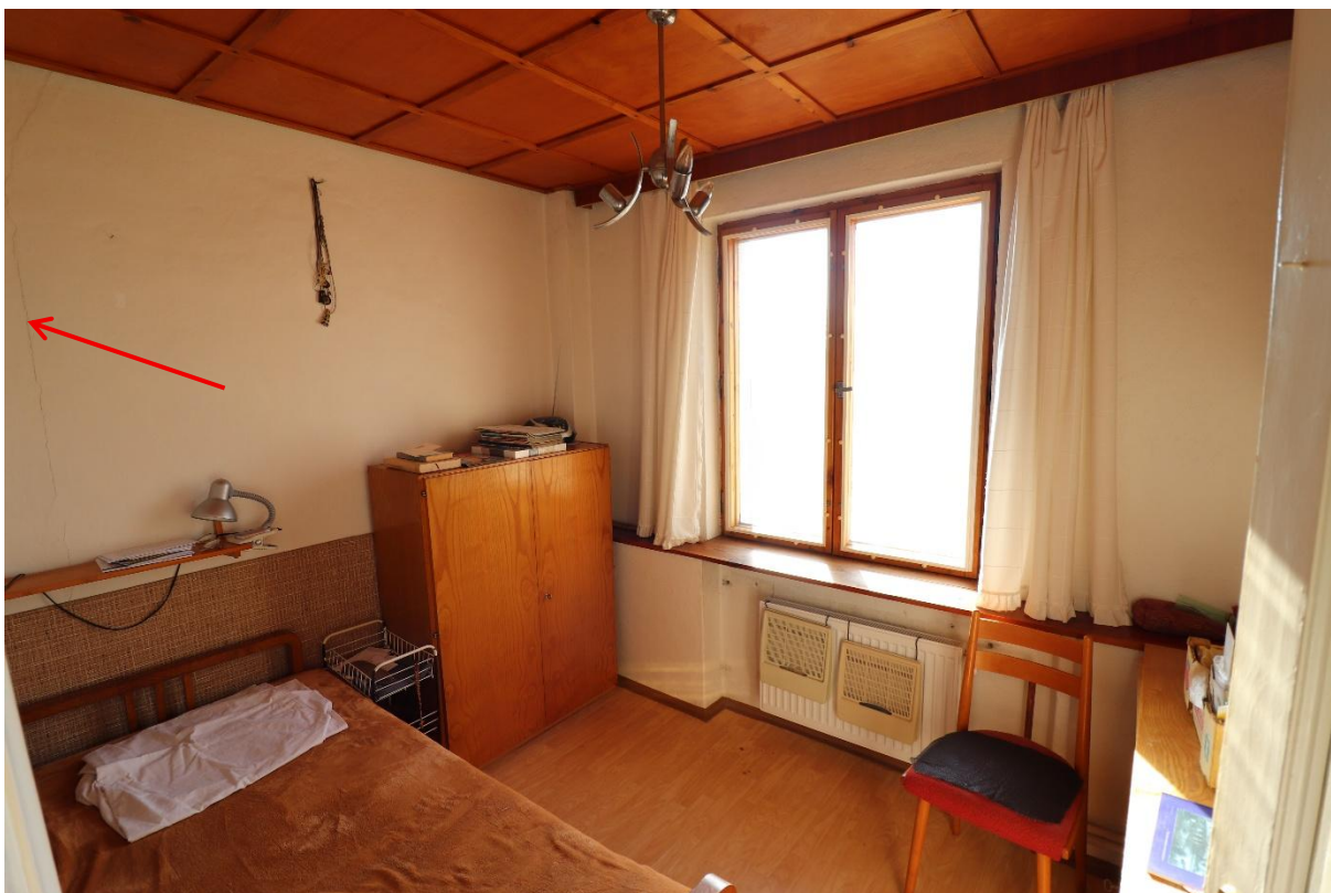
Pokoj 1np – na stěně patrná prasklina
