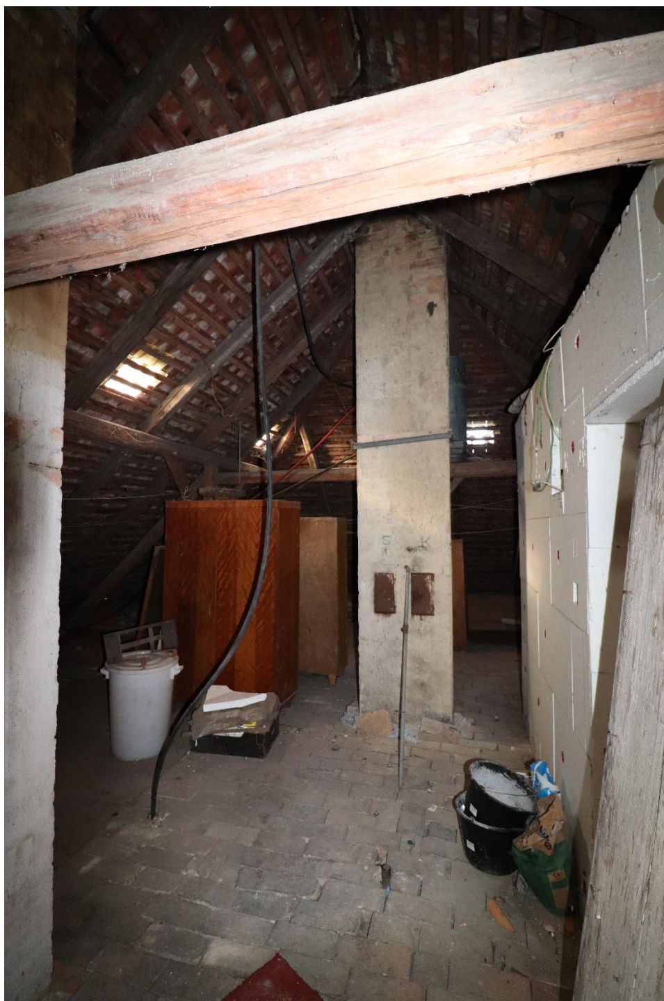
Půda zateplení obytné místnosti polystyrenem, patrný průhyb podlahy z cihelné dlažby
