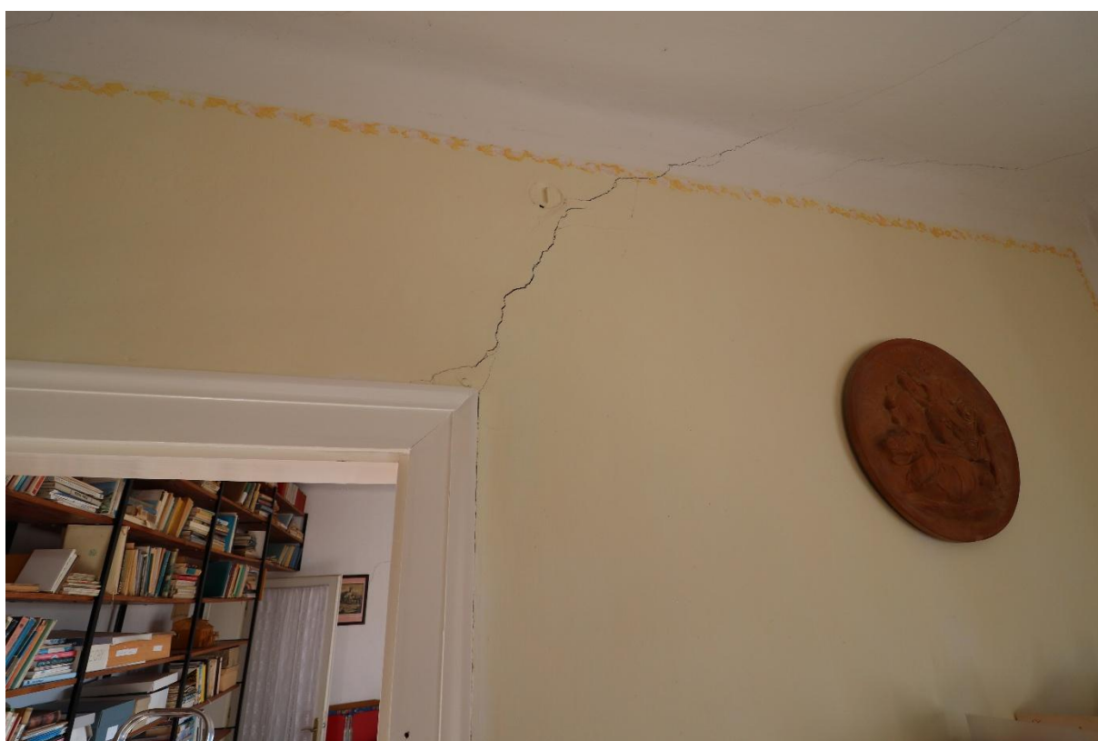
Detail trhliny v příčce
