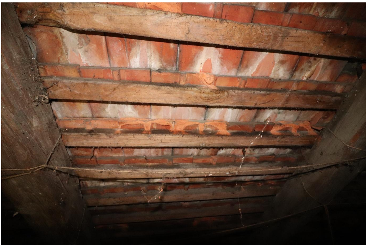
Z degradované střešní tašky
