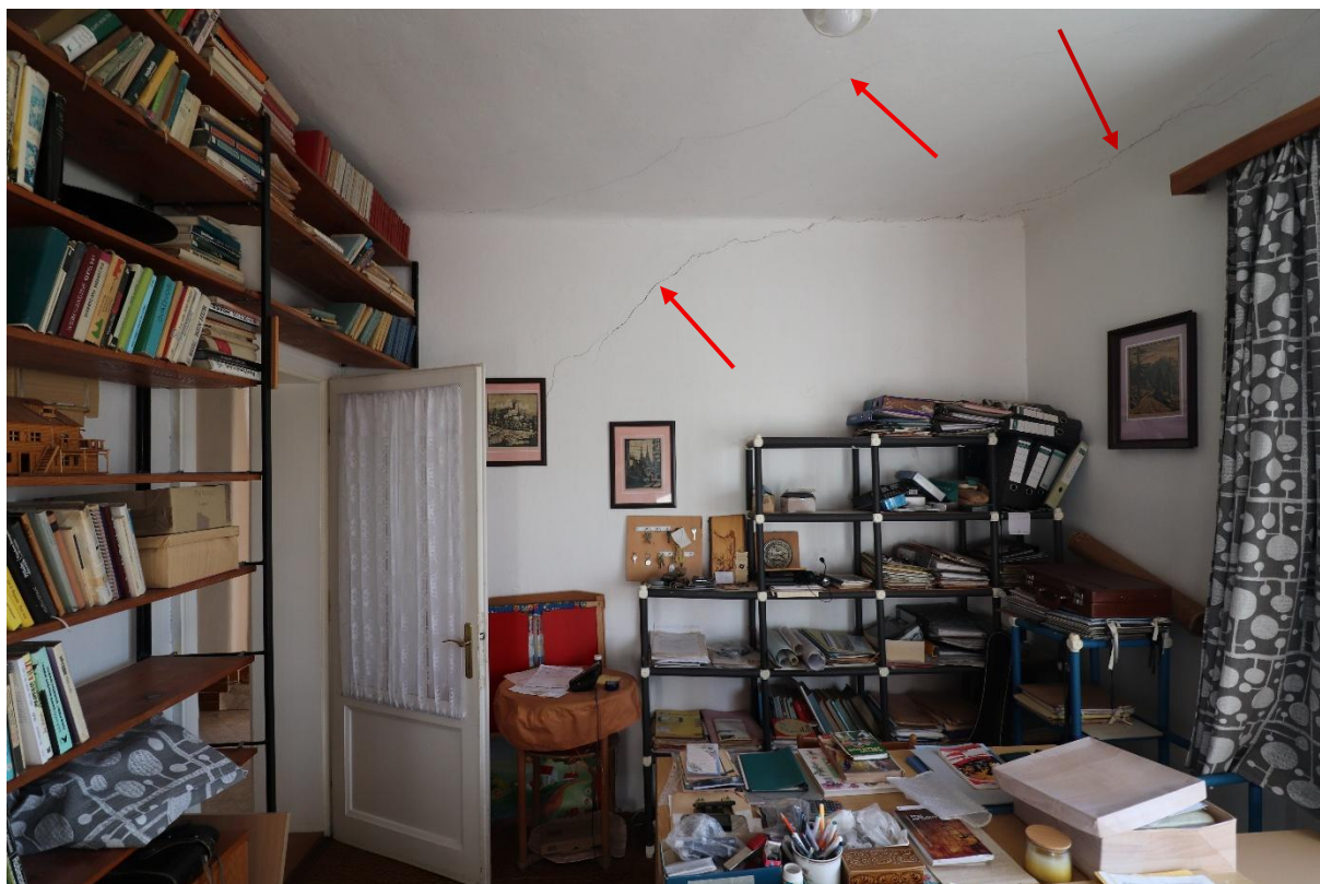
Pokoj praskliny v příčce a v podhledu stropní konstrukce
