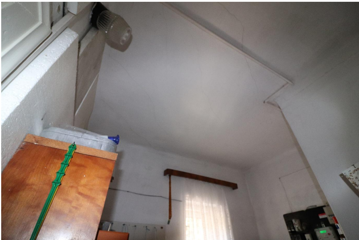
Spíž vlasové trhlinky v podhledu stropní konstrukce
