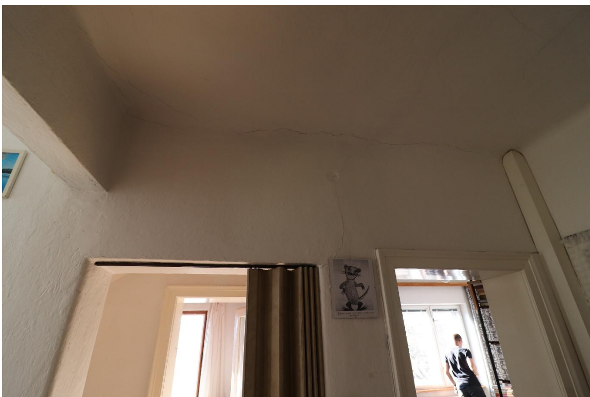
Chodba vlasové trhliny ve stropní konstrukci
