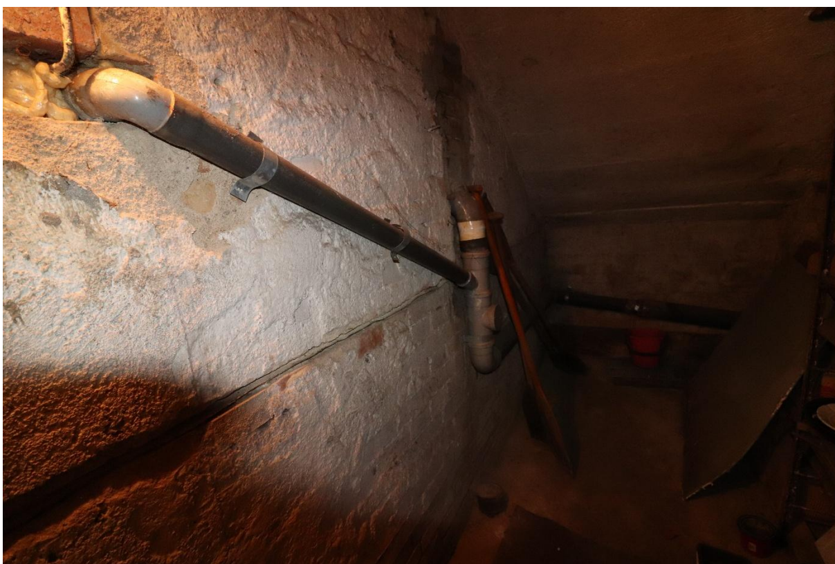
Suterén lepená pvc kanalizace pod verandou
