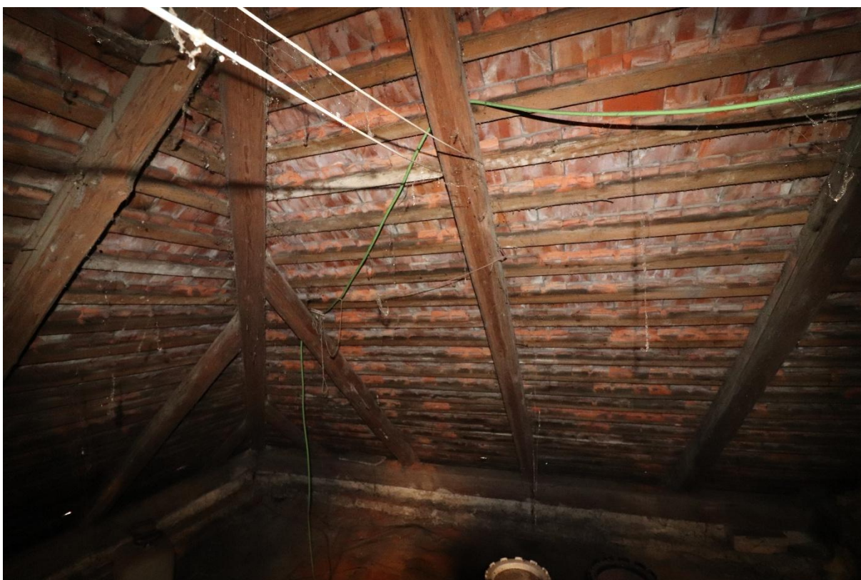
Z degradované střešní tašky
