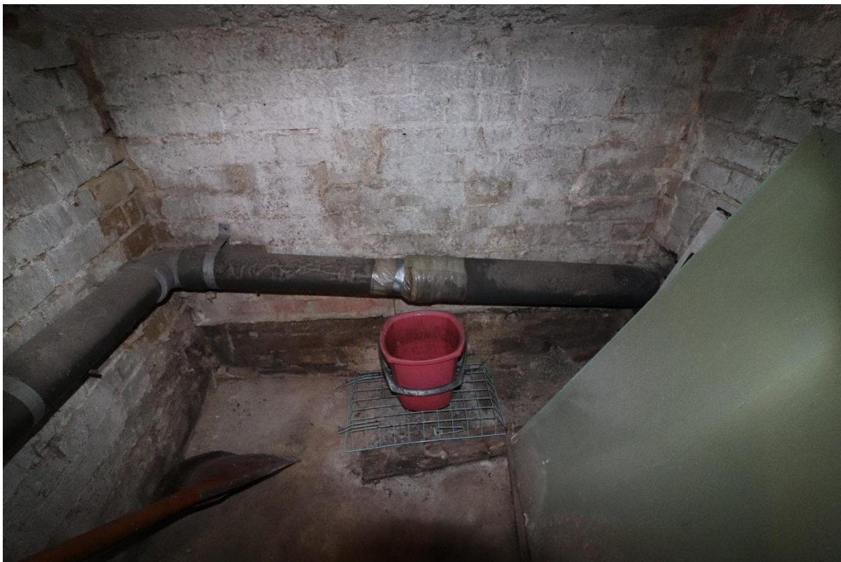
Suterén poškození kanalizace, patrný průsak
