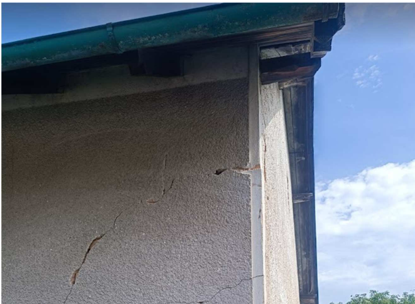
obr.3 detail trhliny - exteriér
