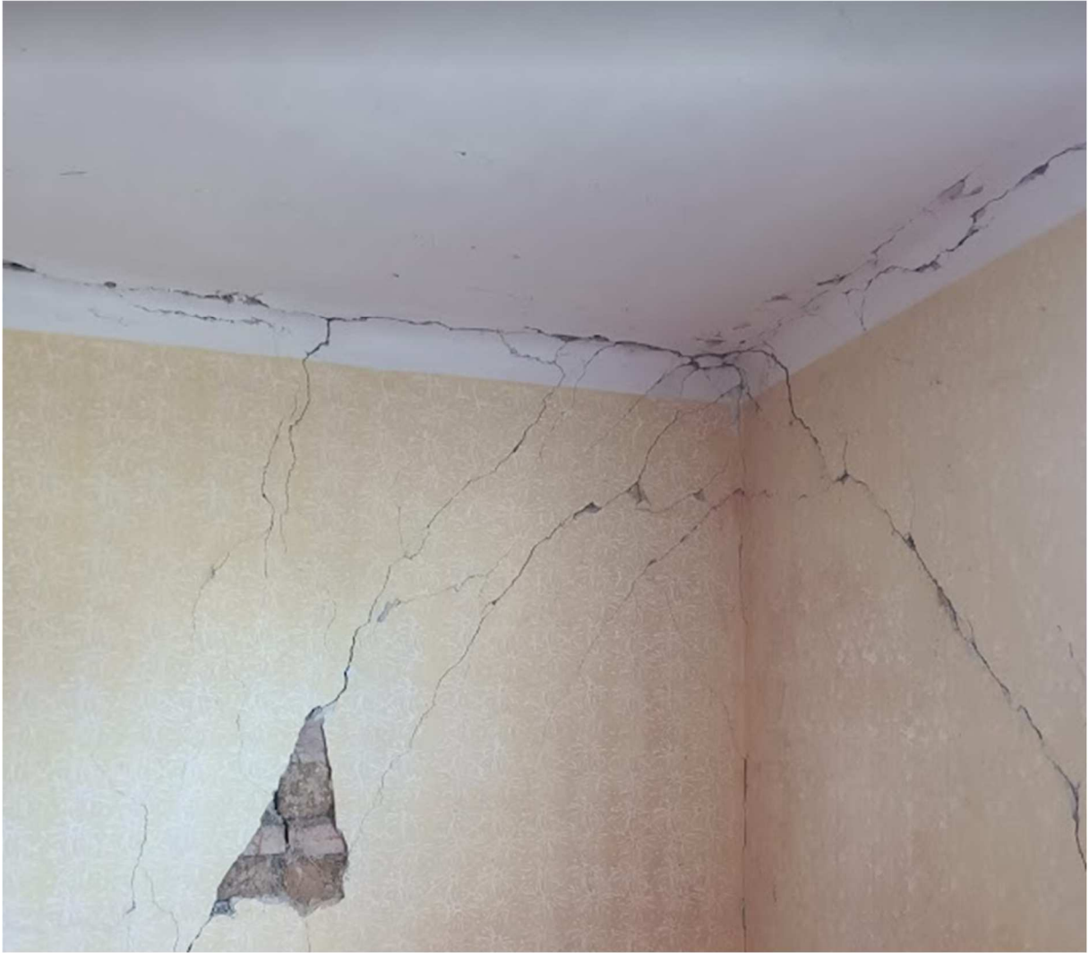
obr.4 detail trhliny - interiér
