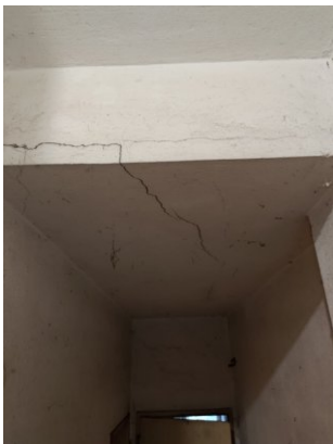
Trhliny ve stropě
