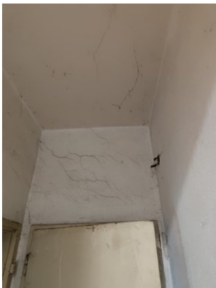
Trhliny v příčce
