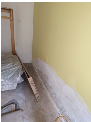
Stěna poškozená vlhkostí z balkonu.
