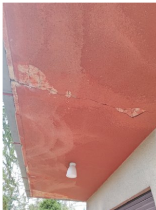
Trhlina ve stropě
