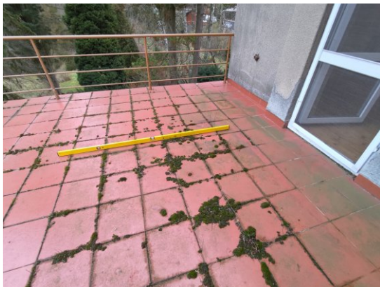
Dožilá podlaha na terase
