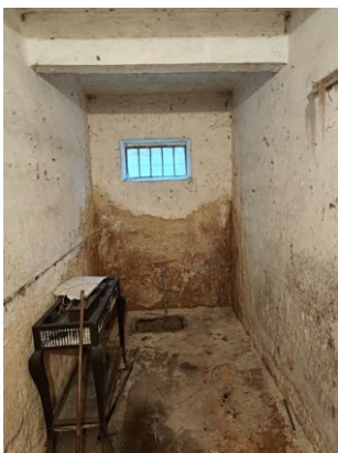
Stěna ve sklepě poškozená vlhkostí
