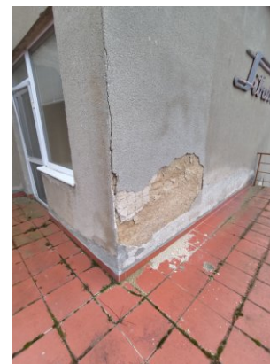
Stěna poškozená vlhkostí z balkonu.
