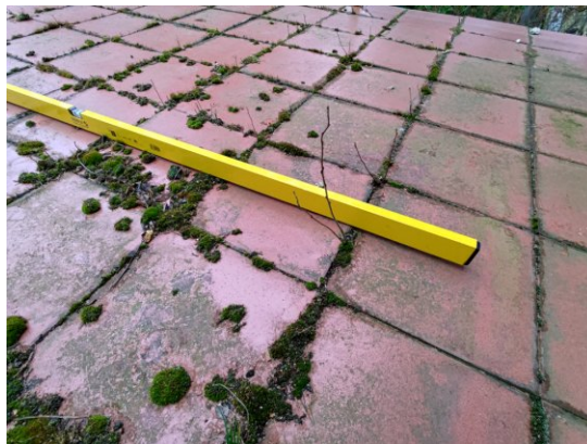
Dožilá podlaha na terase
