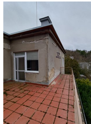
Trhlina ve stěně a stropní desce
